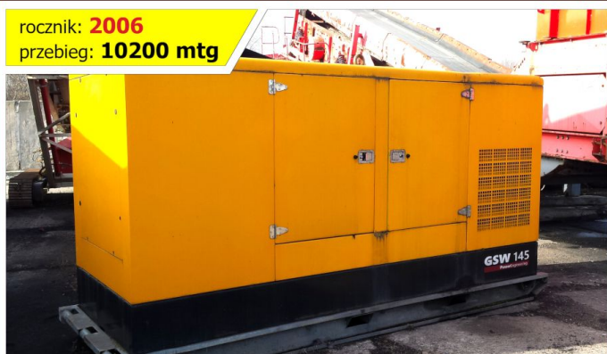
Generator prądu PRAMAC GSW 145
